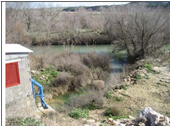
Detalle de la entrada de agua en una toma directa del río Alcanadre para regadío situada aguas arriba de la localidad de Sena. En el año 2004 se produjeron problemas de suministro por falta de agua ya que fue un año extremadamente seco.
