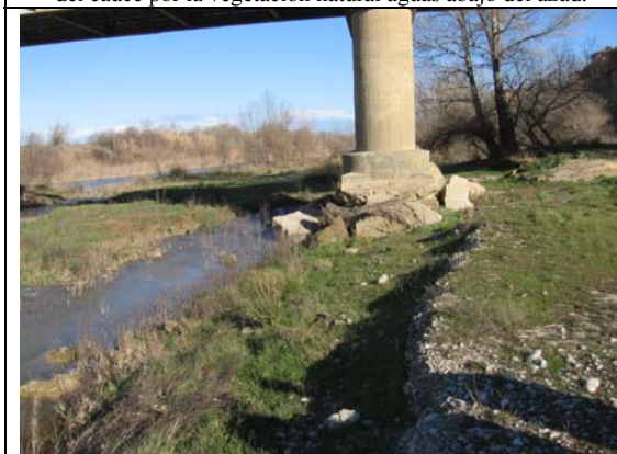
Vista general del río Alcanadre a su paso por el Puente de Hierro situado entre las localidades Sena y Villanueva de Sigena. Sería necesario reforzar el asentamiento de las pilastras
